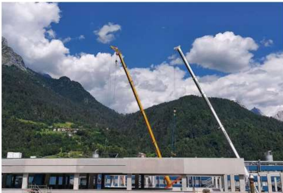
Fig. 3.9: Ampliamento di un insediamento industriale ad Agordo (BL) per la produzione di occhialeria, realizzato tra il 2019 e il 2020 per una superficie complessiva di quasi 1,6 ettari di cantiere, 5.900 m 2 dei quali occupati da nuovi edifici e 4.300 m 2 occupati da aree impermeabilizzate per piazzali, parcheggi e viabilità (immagine 2018 in alto, immagine Triplexat 2020 in centro, fotografia della realizzazione del nuovo fabbricato in basso).
