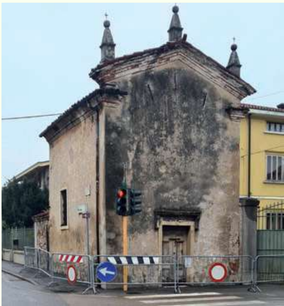
La chiesetta di San Carlo a Monteforte all'incrocio tra Viale Europa e Via San Carlo, in cattive condizioni, pericolante, transennata
